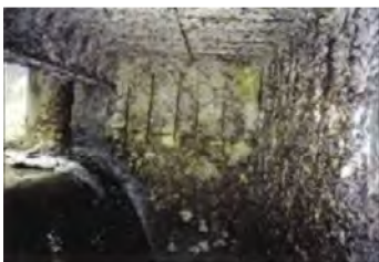
硫酸によるコンクリート劣化
