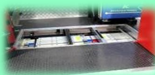
床下搭載蓄電装置
