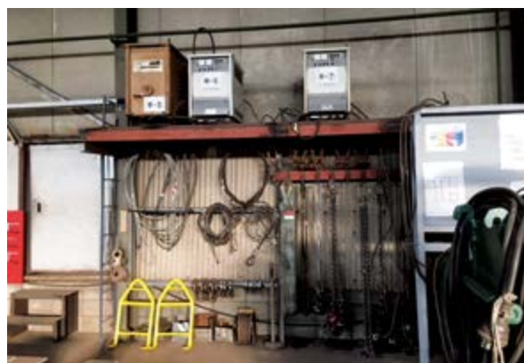
中二階にあげた電源装置
