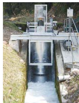
マイクロ水力発電機（低落差タイプ）
