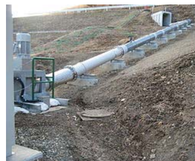
マイクロ水力発電機（高落差タイプ）
