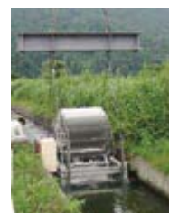
①小水力発電装置
