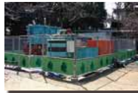
水処理プラント外観
