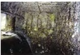
硫酸によるコンクリート劣化
