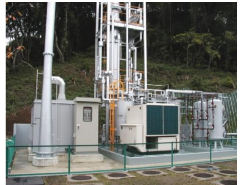
アンモニア排水処理装置全体
