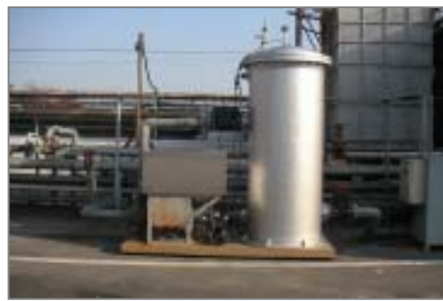
産業排水浄化システム
