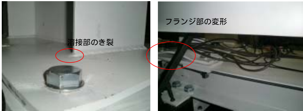
写真-2 バッファ-取付部材の破損状況
