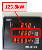
コーティング施工前 モーター電力
