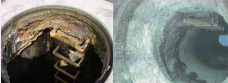
● 腐食劣化したマンホール
