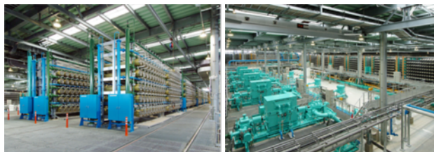
日本最大の海水淡水化施設「まみずピア」 (福岡地区水道企業団)
