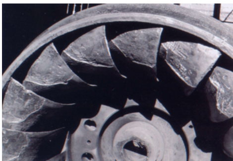
図1 高速水流土砂磨耗腐食によって、使用に耐えられなくなった発電用水車ランナ(修繕前の状態)
