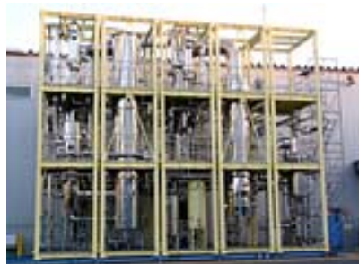
剥離液再生装置
