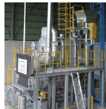
バイオマス水性ガス化装置
