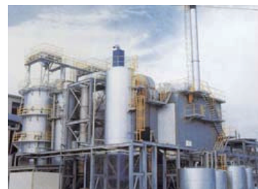
(乾溜ガス化焼却装置)
