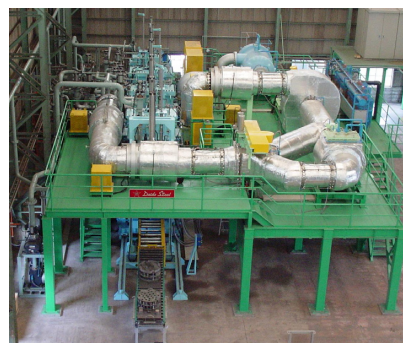
ホットガス乾式炉全容
